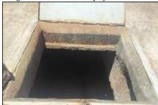
Figura 26 – Abertura do poço amazônico I
