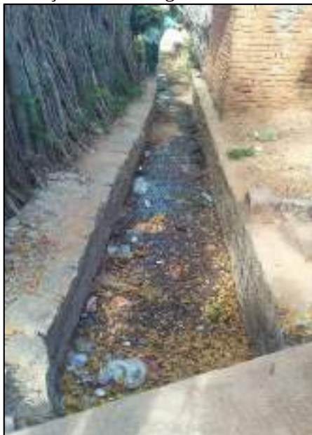
Figura 100 – Lançamento de esgoto na estrutura de drenagem
