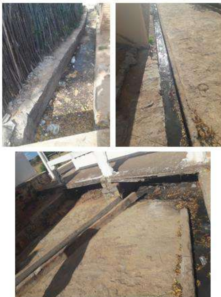
Figura 68 - Pontos de Esgoto a Céu aberto no canal de drenagem
