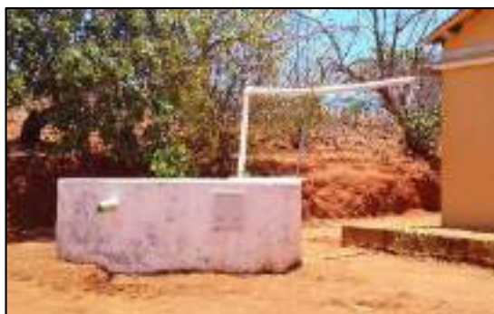
Figura 49 – Cisterna para água de chuva – Sítio Mata
