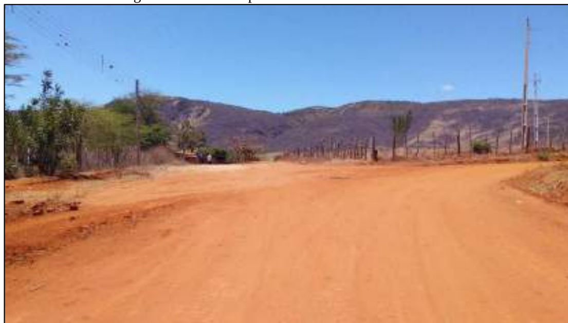
Figura 79 – Rua não pavimentada – Sítio Patos do Irerê
