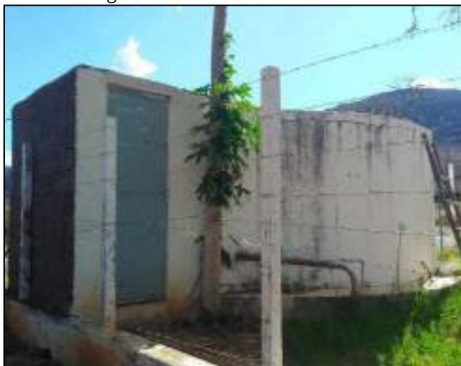
Figura 31 – Reservatório urbano I
