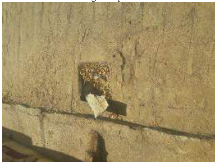
Figura 71- Pontos de entrada de águas superficiais na rede coletora de Esgoto
