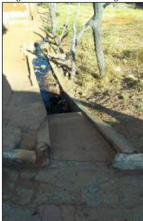
Figura 96 – Estrutura de drenagem II
