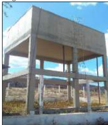
Figura 32 – Reservatório urbano II
