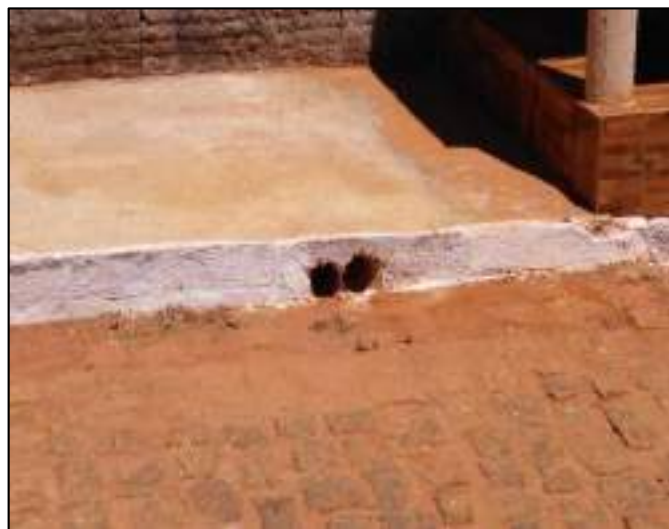
Figura 83 – Tubulação para escoamento da água - Sítio Patos do Irerê
