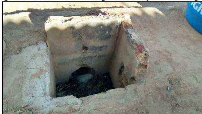
Figura 99 – Estrutura de drenagem IV e lançamento de esgoto
