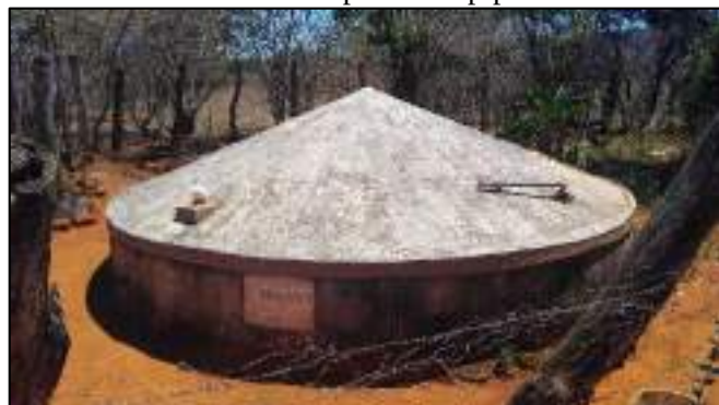
Figura 43 – Cisterna abastecida por carro pipa – Sítio Patos do Irerê
